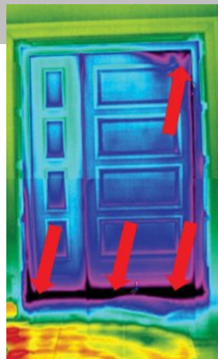
Lokalizacja nieszczelności z zastosowaniem kamery termograficznej
