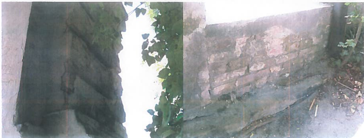
Fot. 9. Ubytki tynku na elewacji północnej
