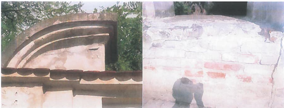
Fot. 8. Zniszczenia tynku na elewacji południowej w rejonie zwieńczenia bramy (fot. lewa) oraz pasa pod furką flankującą (fot. prawa).
