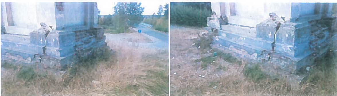
Fot. 3. Wyraźne pęknięcie piedestału budowli w rejonie przyziemia.
