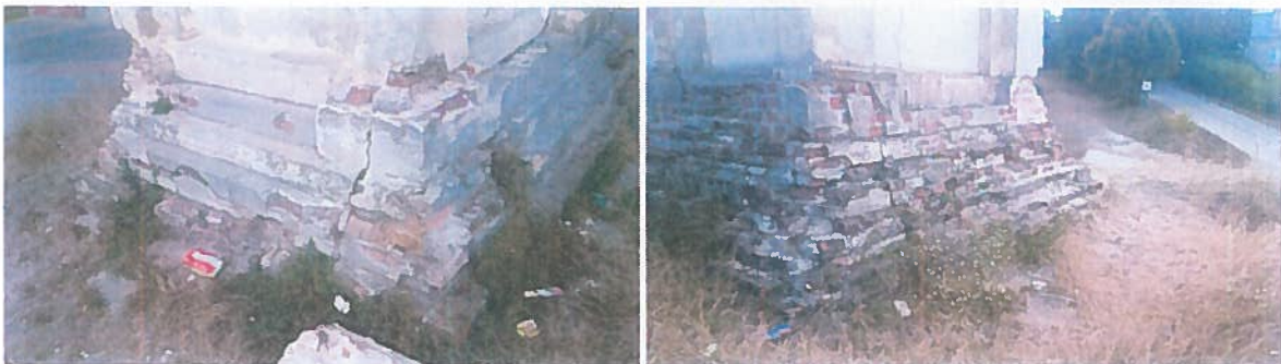
Fot. 2. Zniszczony cokół budowli strona północno-zachodnia (fot. prawa) oraz strona południowo-zachodnia (fot. lewa)
