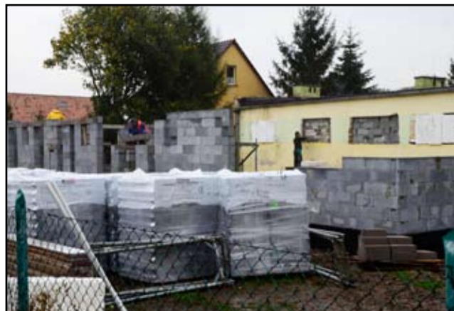
Pogoda czy niepogoda, ekipy budowlane pracują przy budowie nowych świetlic środowiskowych. Tu na zdjęciu powstająca sala w Zastrużu.
