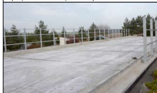
Niebawem odwodniony osad ściekowy będzie poddawany procesowi suszenia w nowoczesnym obiekcie zlokalizowanym przy żarowskiej oczyszczalni.
