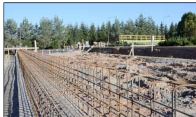
Dzięki nowej solarnej suszarni osady z oczyszczalni ścieków w Żarowie przestaną być wywożone na składowisko. Będą natomiast wykorzystywane jako paliwo lub nawóz w uprawach leśnych.
