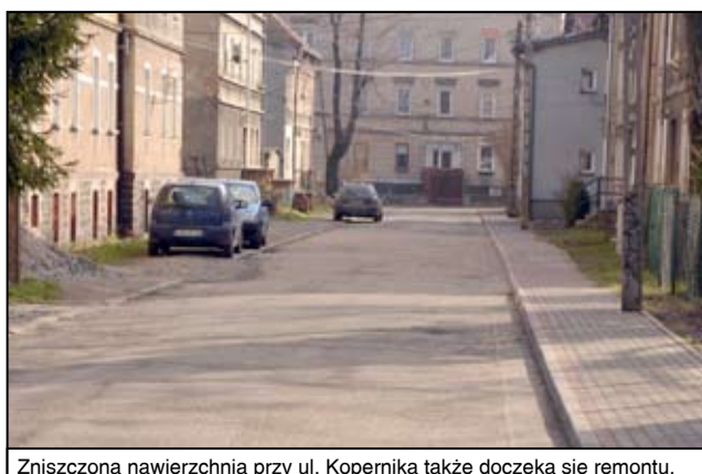
Zniszczona nawierzchnia przy ul. Kopernika także doczeka się remontu.
