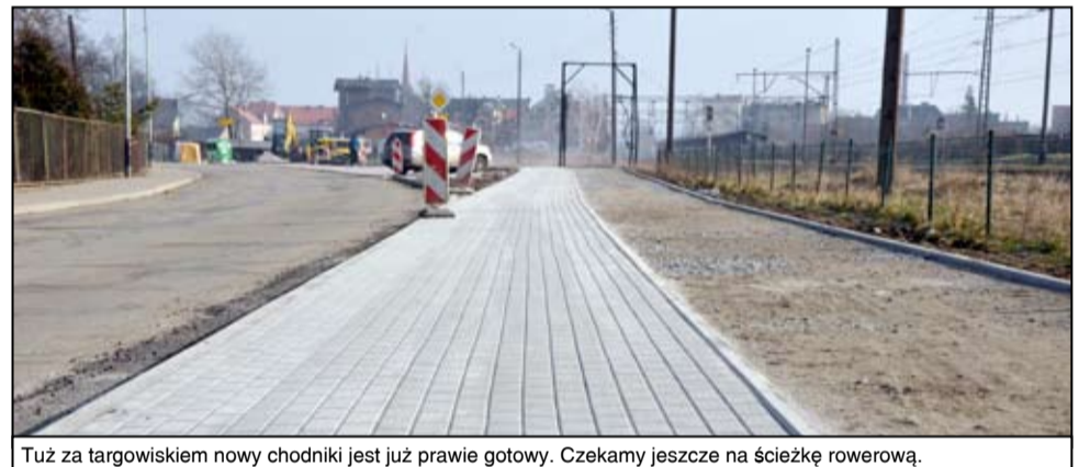
Tuż za targowiskiem nowy chodnik jest już prawie gotowy. Czekamy jeszcze na ścieżkę rowerową.
