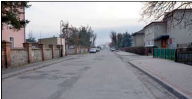
Remonty dróg w mieście to inwestycje długo wyczekiwane przez mieszkańców. W wielu miejscach drogi są w złym stanie technicznym i wymagają kompleksowej modernizacji.
