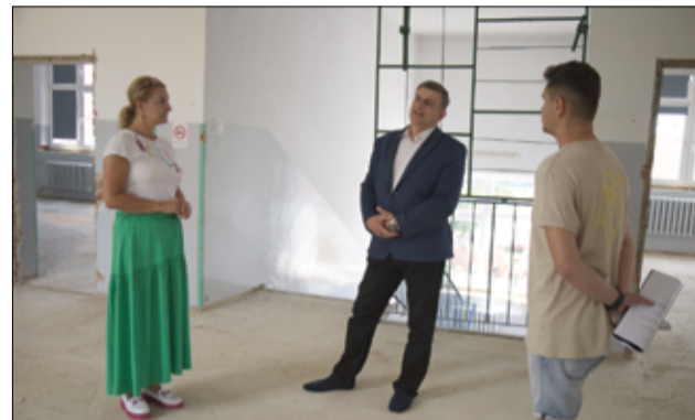
Burmistrz Leszek Michalak spotkał się z kierownikiem budowy oraz dyrektorem szkoły, aby omówić poszczególne etapy inwestycji.
