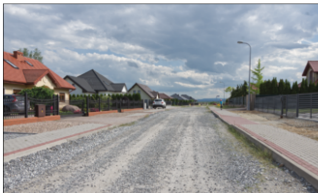
Droga przy ul. Ks. Jadwigi w Żarowie wymaga kompleksowej przebudowy.
