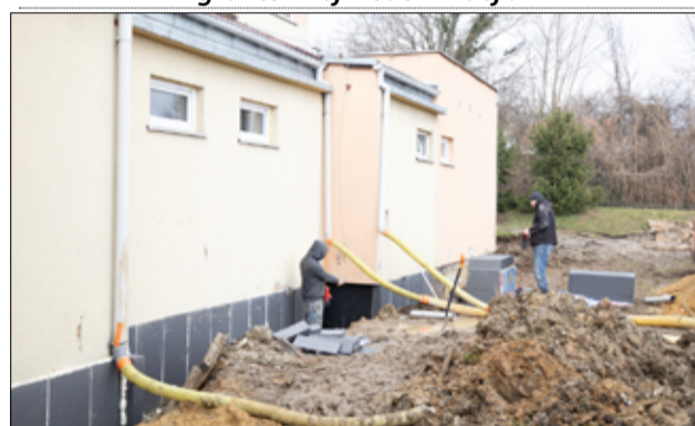
Trwają prace przy realizacji II etapu termomodernizacji budynku Szkoły Podstawowej im. UNICEF w Imbramowicach.
